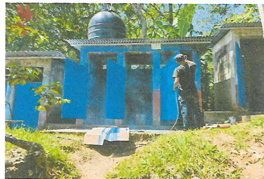
Foto 4: Situación actual de puertas de modulo de baños
